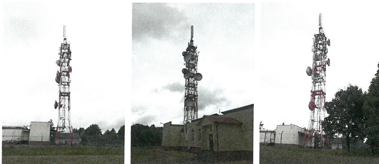
Widok obiektu wraz z zainstalowanym zespołem antenowym
