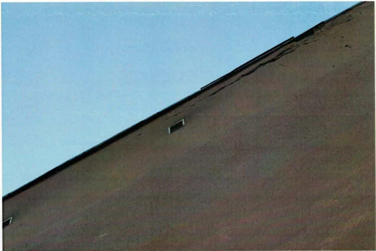
Fot. 2 Spękania elewacji pod samym dachem, kratki wentylacyjne zabezpieczone.
